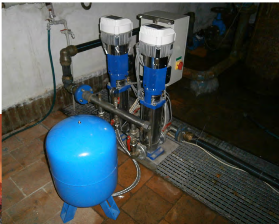
čerpadla HYDROVAR ve vodárně na Solečku
