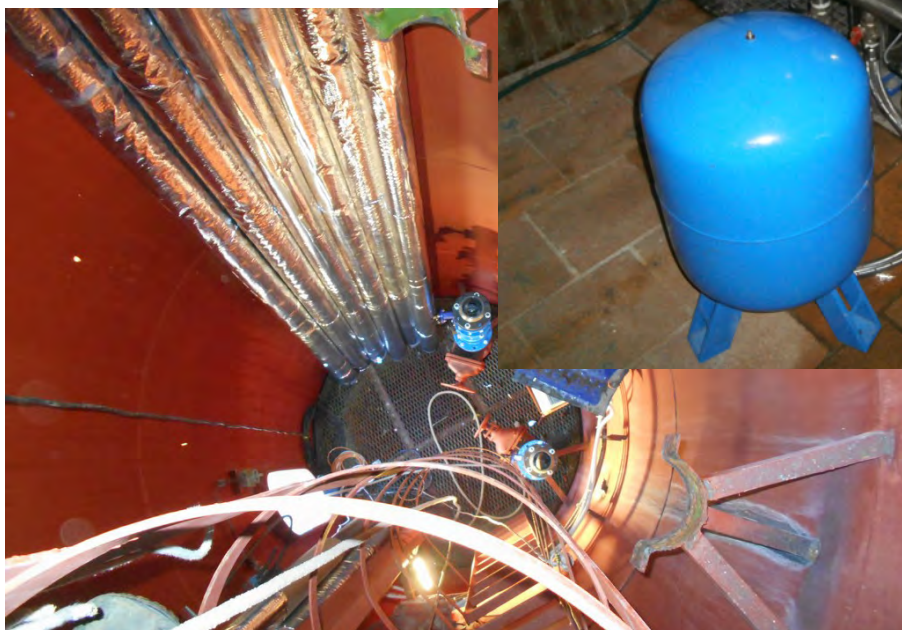
Pohled do „nohy“ vodojemu s novým tepelně izolovaným potrubím
